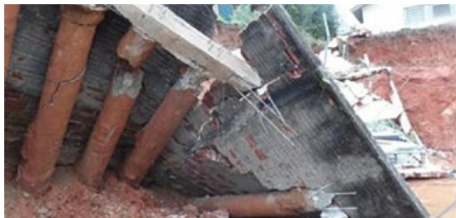
Figura 3 – Falha no dimensionamento ou execução de uma contenção pode resultar em colapso pelo empuxo lateral, caracterizando uma anomalia endógena
