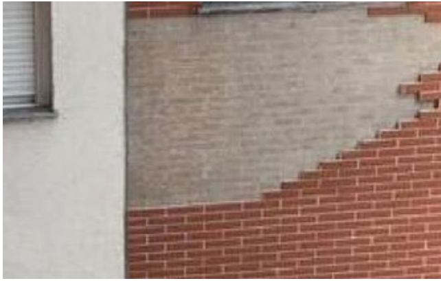
Figura 16 - Defeito construtivo, pois a queda sobre o térreo pode ferir alguém. O revestimento deve possuir aderência à sua camada anterior.
