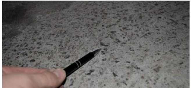
Figura 13 – O desgaste por abrasão, decorrente do atrito do pneu contra a pavimentação, é normal ocorrer com os anos. O material mostrou-se apto durante muitos anos e não há indícios que o caracterize como viciado. O condomínio deve promover um "recapeamento" dos trechos mais desgastados
