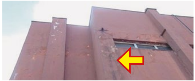
Figura 12 – Desgaste do selador, pintura e fadiga no revestimento
