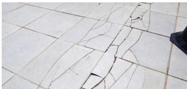
Figura 6 – Ausência de junta de dilatação em não atendimento à ABNT NBR 13.753 e ABNT NBR 9817
