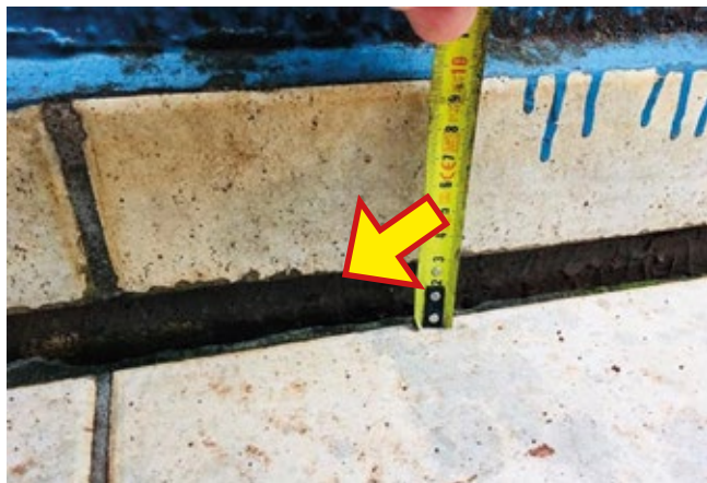
Figura 1 – O precoce afundamento no piso, decorrente de adensamento do solo suporte, é uma anomalia de origem
