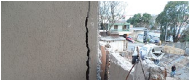
Figura 8 – Avarias à edificação preexistente em virtude de desconfinamento do solo e deslocamento da fundação pela escavação em obra vizinha
