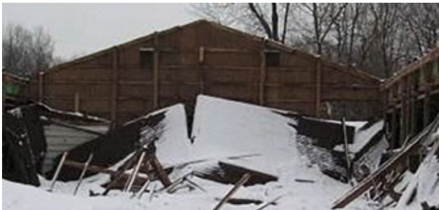
Figura 9 – Eventos de neve em grande quantidade são incomuns no Brasil, não havendo parâmetro normativo que exija sua consideração. Normalmente o trecho mais afetado são as coberturas que acumulam carga não prevista
