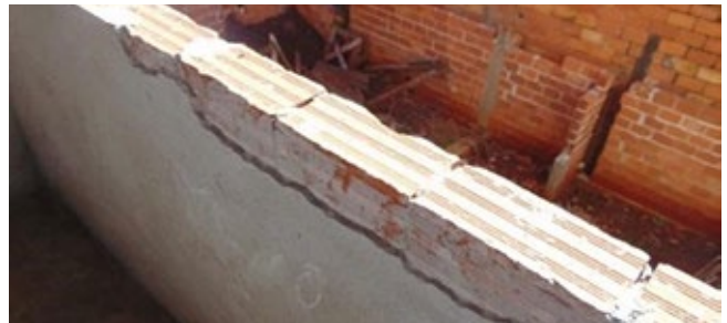
Figura 14 – Ausência de contraverga em janela
