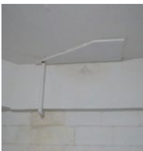
Figura 11 - Infiltração pela área descoberta, resolvida através da "calha" e direcionada para a drenagem da contenção. A infiltração por si pressupõe que se foi constatada e deveria ter sido corrigida com reparos na impermeabilização. Ao captar a água infiltrada pela laje de concreto armado, há riscos de lixiviar e danificar lentamente o concreto, podendo gerar riscos futuros. Esta técnica de "correção" é temerária
